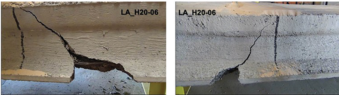
Figura 19: Ruptura por cisalhamento e flexão com falha de ancoragem – LA_H20-06 [15].
