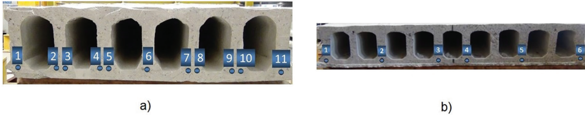
Figura 7: Posição das cordoalhas: (a) para laje de 300 mm, (b) para laje de 200 mm [15]. Fonte: [14].
