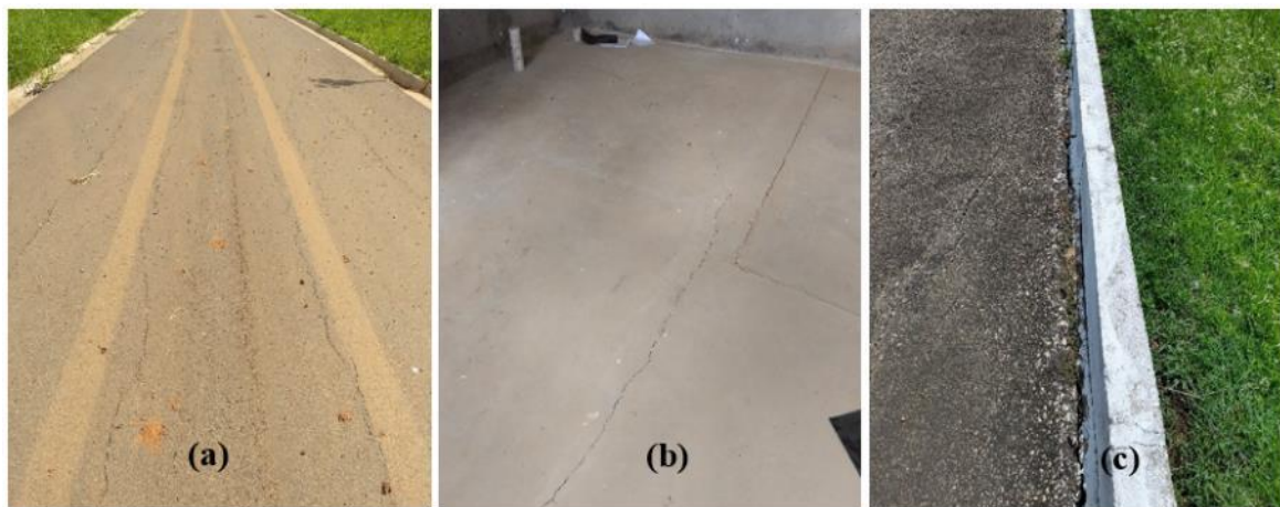
Figura 1: Registros de defeitos em pavimentos e edificações nos arredores de Rio Branco devido à elevada expansibilidade do subleito - (a) Trincas Longas Longitudinais em Pavimento flexível; (b) Trincas em contrapiso de edificação; (c) Soerguimento e trincas nos bordos de Pavimento Flexível.
