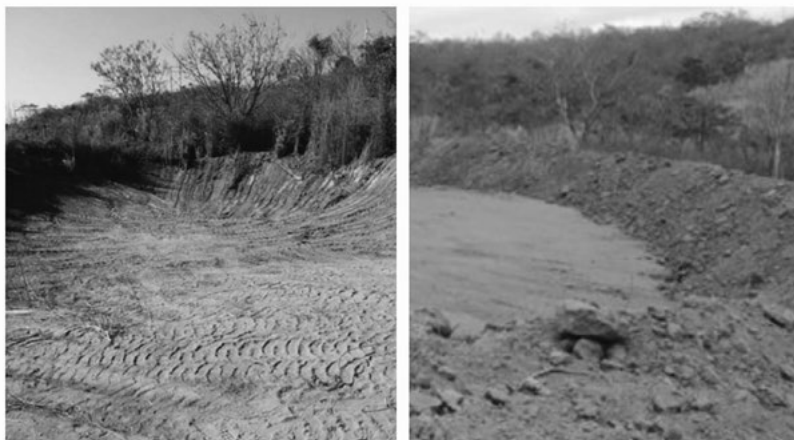
Figuras 2. Bacia de contenção à esquerda e bacia ampliada à direita
