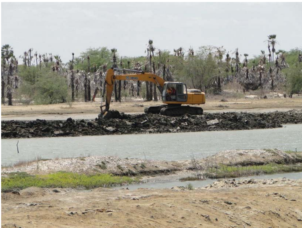
Figura 1 - Máquina realizando a dragagem do leito do rio das conchas, Porto do Mangue, Rio Grande do Norte.
