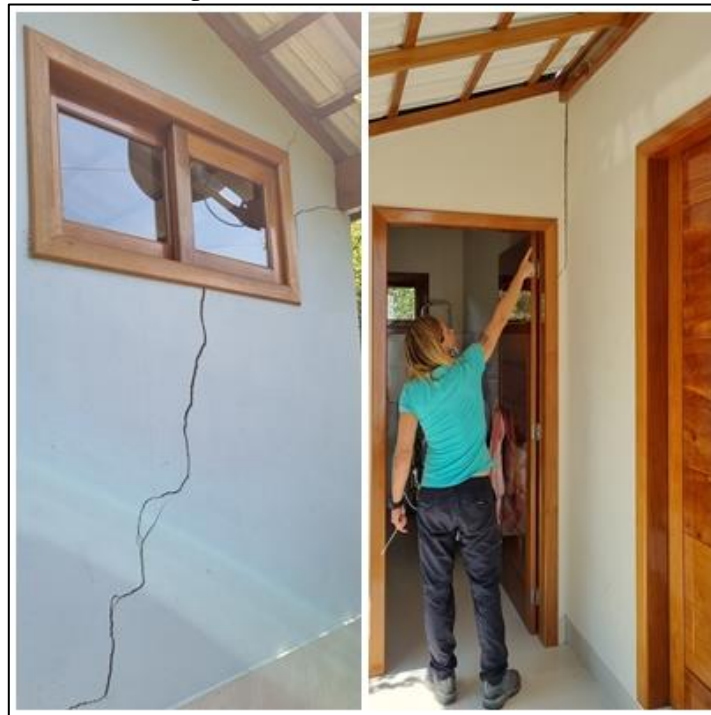
Figura 13 – Danos em residência
