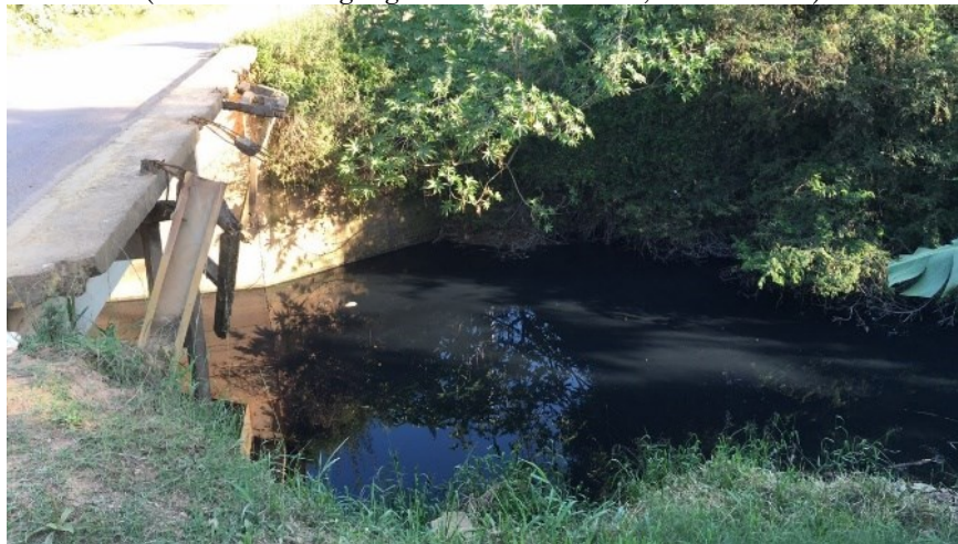
Figura 2 - Trecho do APF (Guaíba/RS) comprometido pelo despejo irregular da atividade industrial (Coordenadas geográficas 30°09'29"S, 51°20'19"W).
